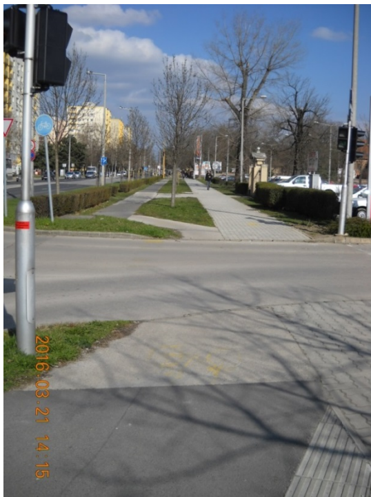
3. kép: Budai úti kerékpárúton a Zrínyi utcai jelzőlámpás keresztezésnél lekopott az utat keresztező kerékpárút burkolatjele
